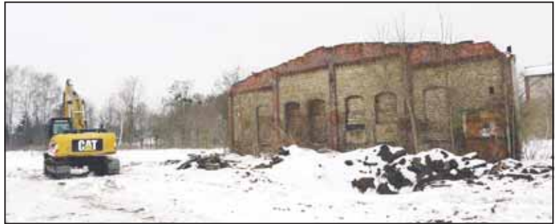
Dieser Hallenmauerrest steht auf dem Grund und Boden eines privaten Eigentümers und harrt noch des Abrisses
