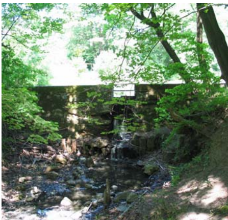
Abbildung 16: Auslass Teich Neue Mühle
