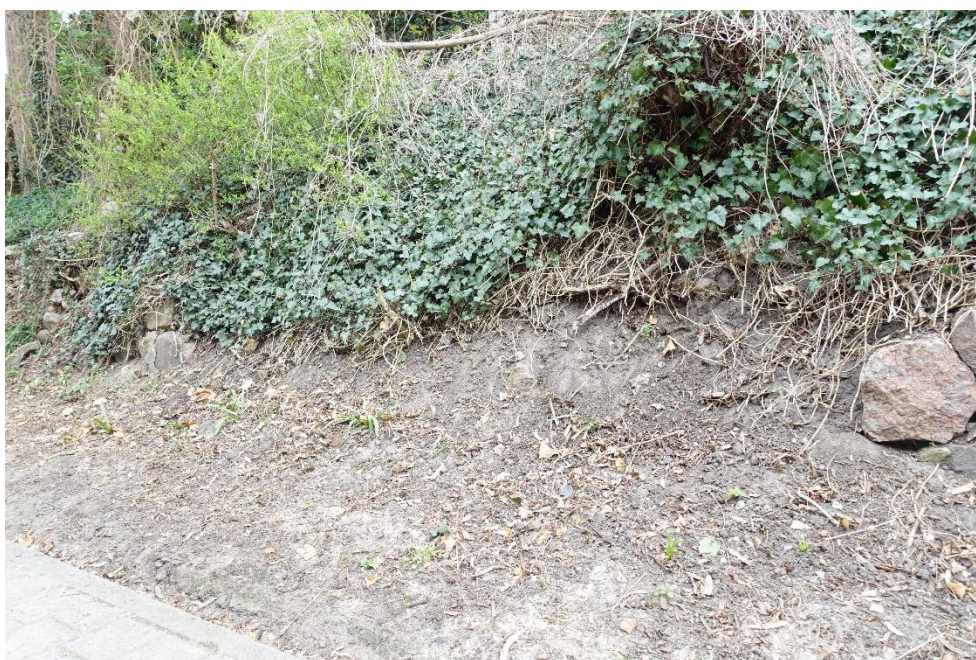
Konstruktiv geschädigtes bzw. abgängiges Natursteinmauerwerk der Wallmauer, Beispiel Fischerkietz - Foto ibs, 16.04.2026
