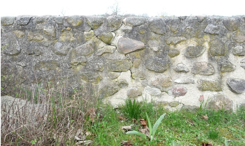
Rissbildung im Natursteinmauerwerk zwischen Alt- und Neumauerwerk, Innenseite, Beispiel Georg-Kurtze-Str. 16 - Foto ibs, 16.04.2026.
