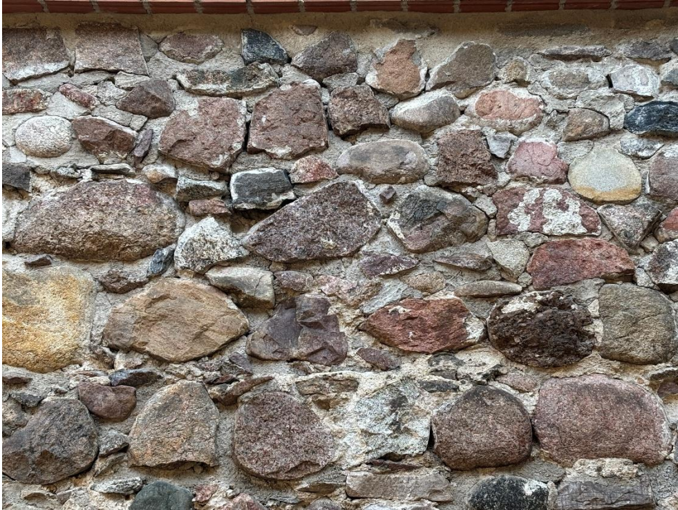
Geschädigte Mauerwerksfugen Naturstein, Beispiel Georg-Kurtze-Str. 1 - Foto ibs, 16.04.2026
