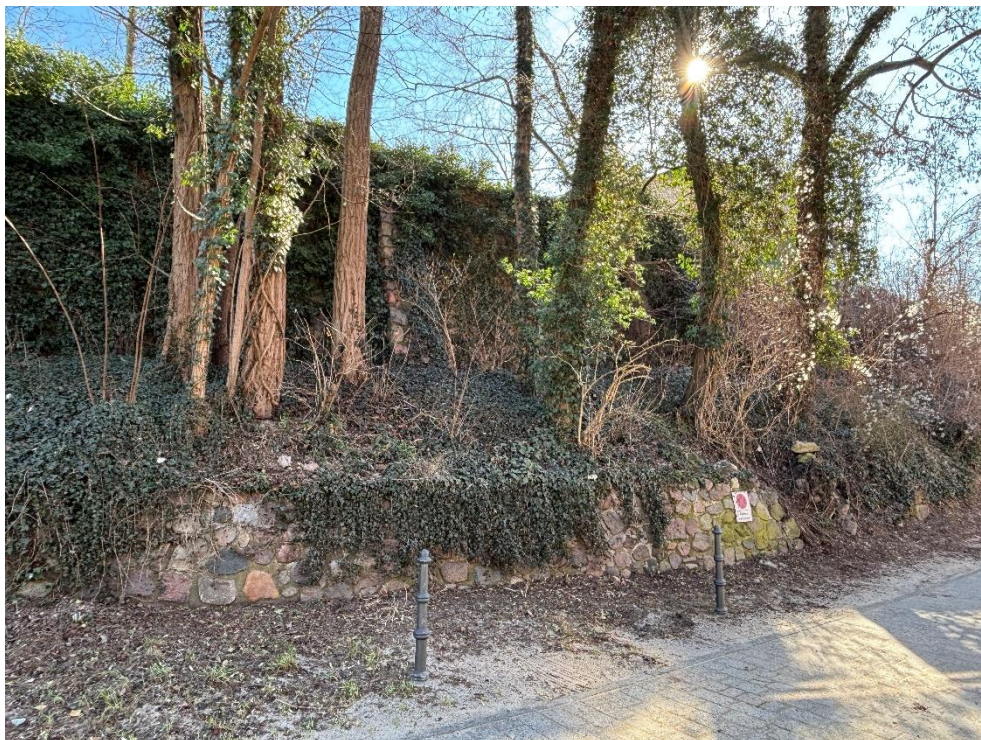
Flächiger pflanzlicher Bewuchs an der Fläche der Stadt- und Wallmauer, Beispiel Fischerkietz - Foto ibs, 04.03.2026
