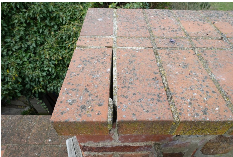
Geschädigte Ziegelabdeckung auf Natursteinmauerwerk, Beispiel Georg-Kurtze-Str. 26 Foto ibs, 16.04.2026
