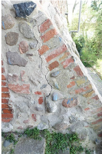
Rissbildung im Mauerwerkstrebpfeiler, Außenseite, Beispiel Georg-Kurtze-Str. 26 Foto ibs, 16.04.2026.
