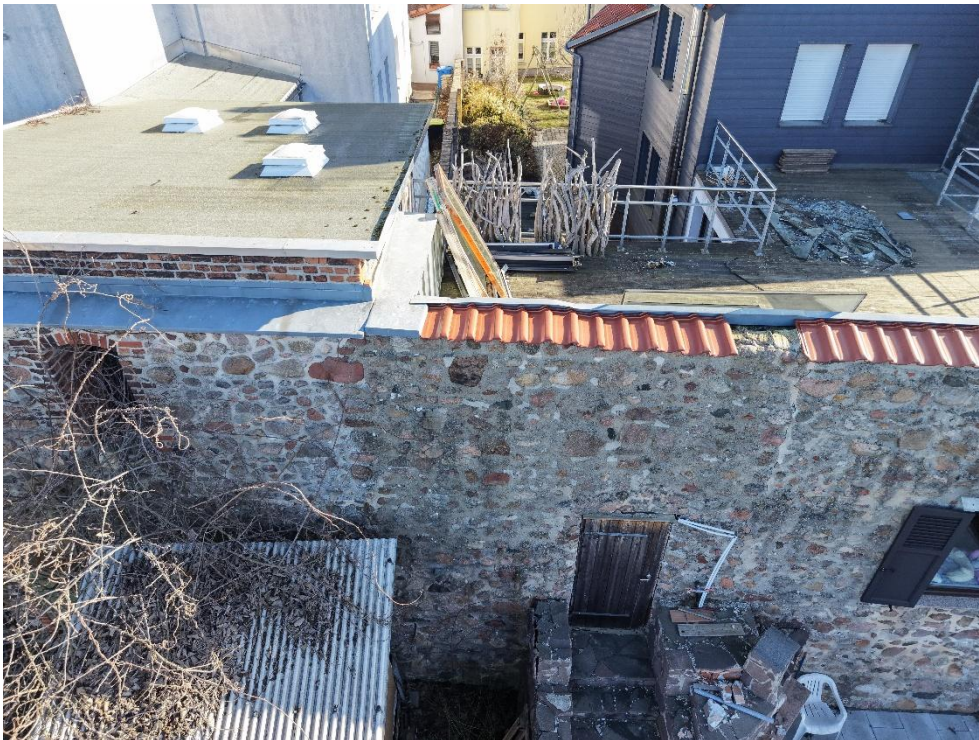
Geschädigte Dachziegelabdeckung auf Natursteinmauerwerk, Beispiel Georg-Kurtze-Str. 8 Foto ibs, 04.03.2026
