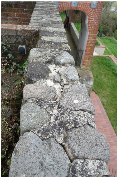
Geschädigte Natursteinmauerkrone, Beispiel Georg-Kurtze-Str. 17 Foto ibs, 16.04.2026
