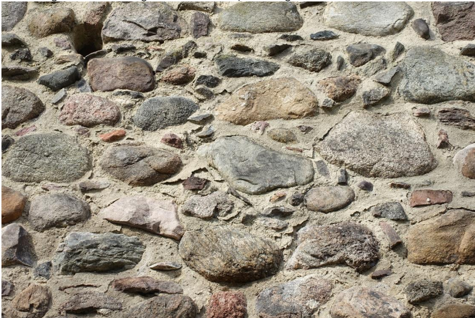
Geschädigte Mauerwerksfugen Naturstein, Beispiel Georg-Kurtze-Str. 4-5 - Foto ibs, 16.04.2026
