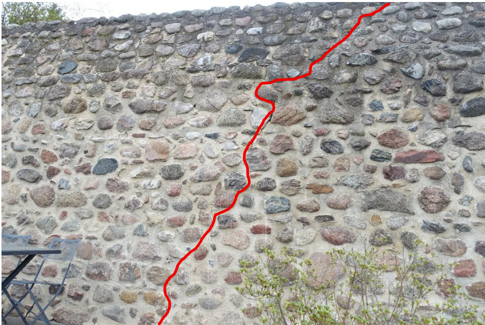
Rissbildung im Natursteinmauerwerk zwischen Alt- und Neumauerwerk, Außenseite, Beispiel Georg-Kurtze-Str. 17 - Foto ibs, 16.04.2026.
