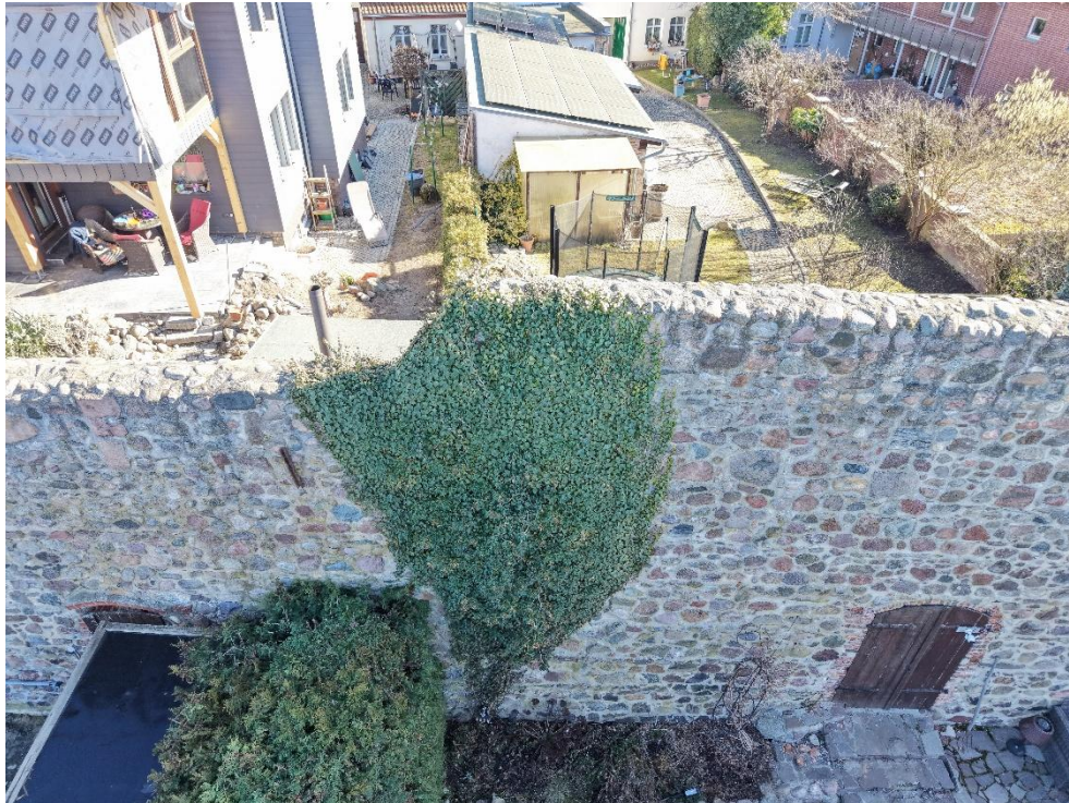
Flächiger pflanzlicher Bewuchs an der Mauerfläche und Gräserbewuchs auf der Mauerkrone, Beispiel Georg-Kurtze-Str. 6 - Foto ibs, 04.03.2026
