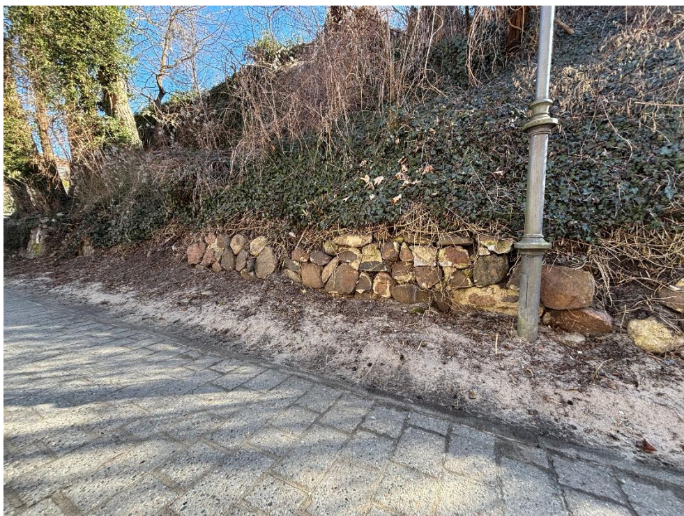
Konstruktiv geschädigtes Natursteinmauerwerk der Wallmauer, Beispiel Fischerkietz Foto ibs, 04.03.2026
