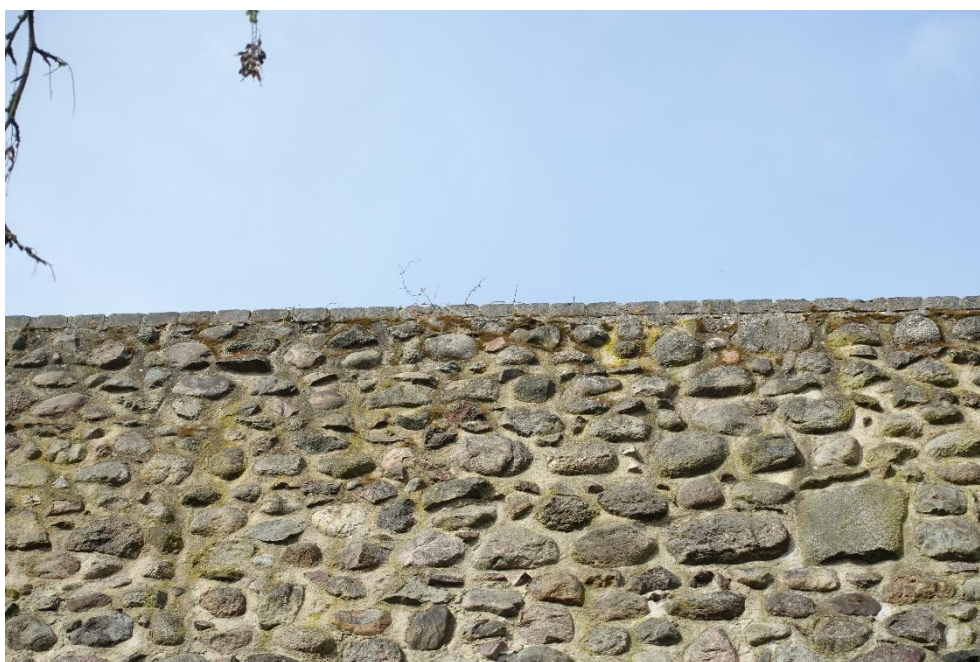
Geschädigte Ziegelabdeckung auf Natursteinmauerwerk mit pflanzlichem Bewuchs, Beispiel Georg-Kurtze-Str. 4-5 - Foto ibs, 16.04.2026
