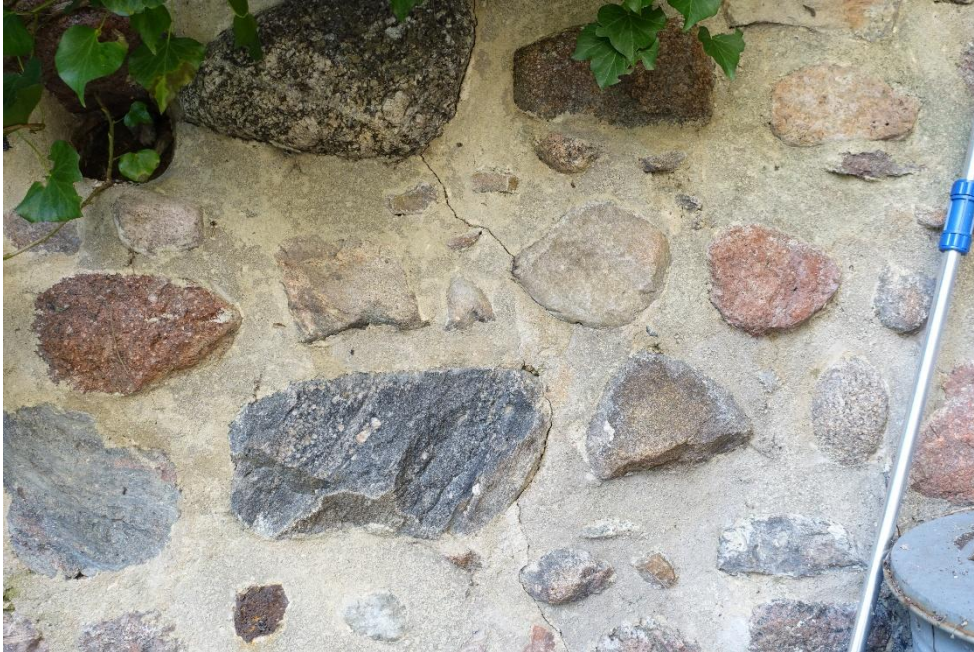
Rissbildung im Natursteinmauerwerk Weichhaus, Beispiel Georg-Kurtze-Str. 4-5 Foto ibs, 16.04.2026.
